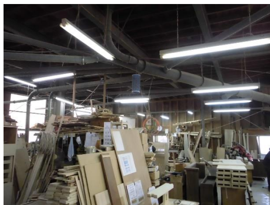
【 工場の蛍光灯 】
